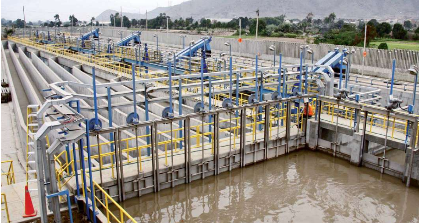
PLANTA DE TRATAMIENTO DE AGUA DE HUACHIPA.
