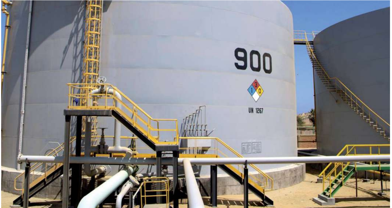
PLANTA DE TRATAMIENTO DE AGUA DE LASTRE. REFINERÍA DE TALARA.
