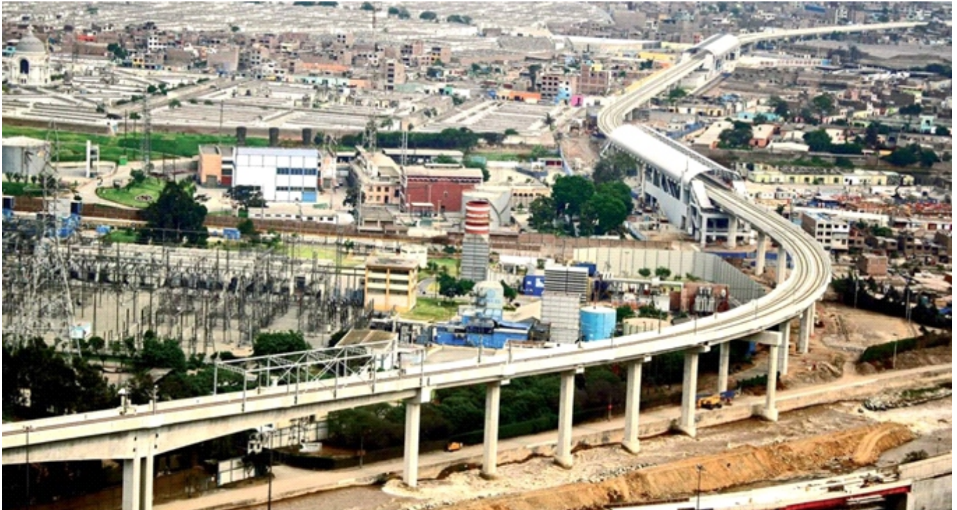
METRO DE LIMA. LÍNEA 1: VILLA EL SALVADOR - SAN JUAN DE LURIGANCHO. 34 KM.
