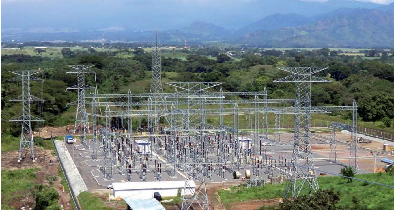
SUBESTACIÓN SOCABAYA Y LÍNEAS DE TRANSMISIÓN 220 kV Y 138 kV A CERRO VERDE Y CHARCANI V. DISEÑO Y SUPERVISIÓN DE OBRA.
